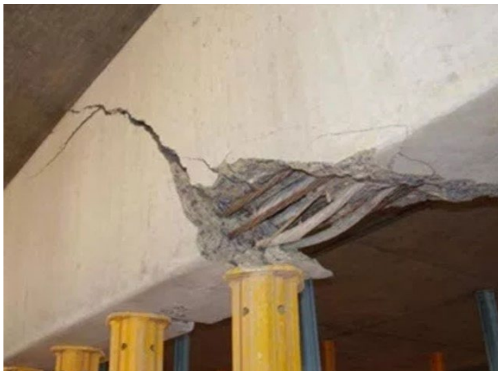
Figur 2 Skador på grund av överlast i en spännarmerad betongbalk ( https://myrenovationspecialist.com )
