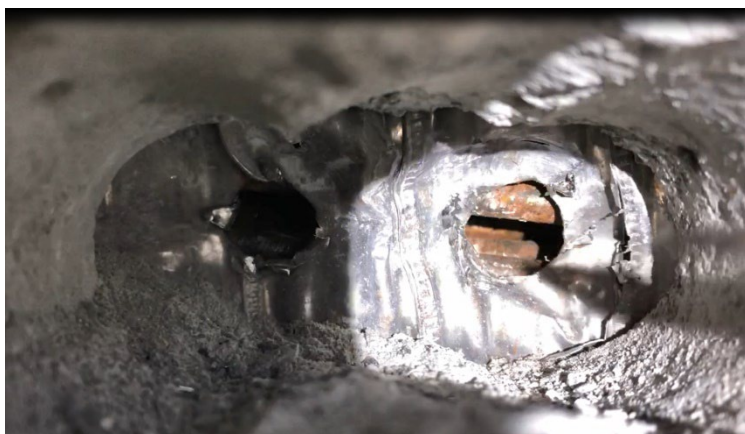
Figur 89 Uppborrat hål i foderrör 3SC med brott i spännlinor
