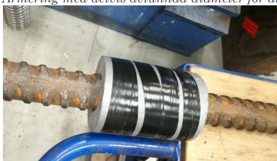
Ingjuten defekt i form av polystyren
