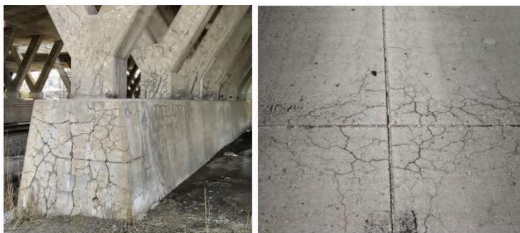
Figur 3 Typiska ASR angrepp hos betongkonstruktioner, ( www.mekaglobal.com )
