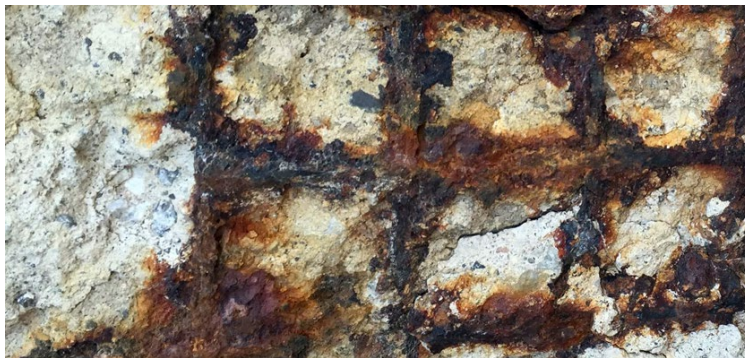
Figur 8 Korrosion orsakad av karbonatisering
