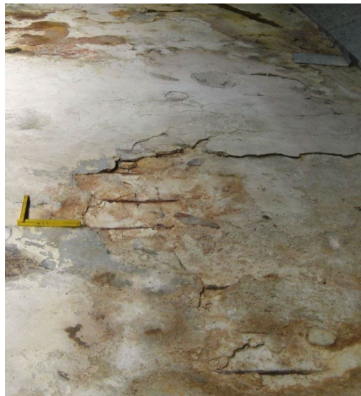
Figur 4 Typiskt syraangrepp på ett betonggolv (Bögh & Nielsen, 2015)
