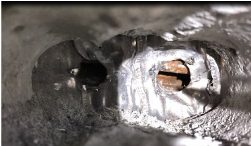
Figur 81 Kablar i foderrör 3SC med kabelbrott
